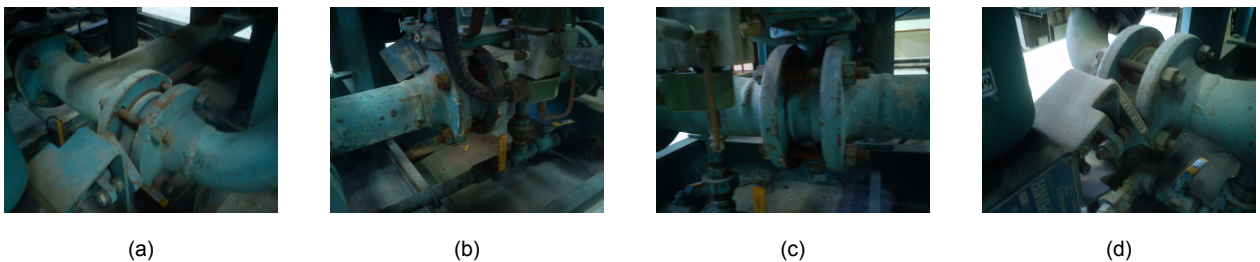
Figura 9: a) Válvula de egreso de aire caliente a 1001A b) Válvula de egreso de gas a 1001A c) Válvula de egreso de aire caliente a 1001B d) Válvula de egreso de gas a 1001B
