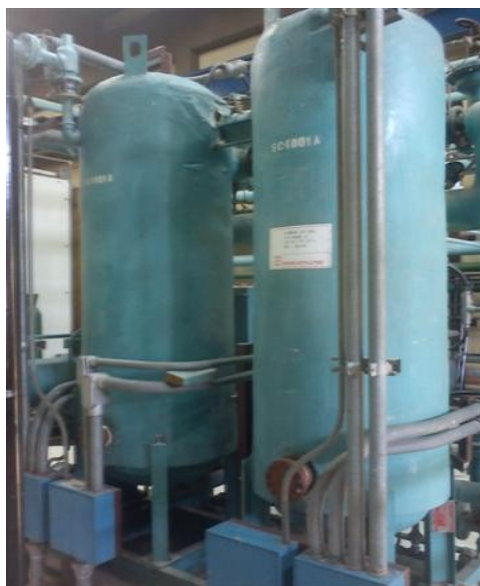
Figura 1: Tanques de alojamiento de alúmina SC-1001A Y SC1001B
