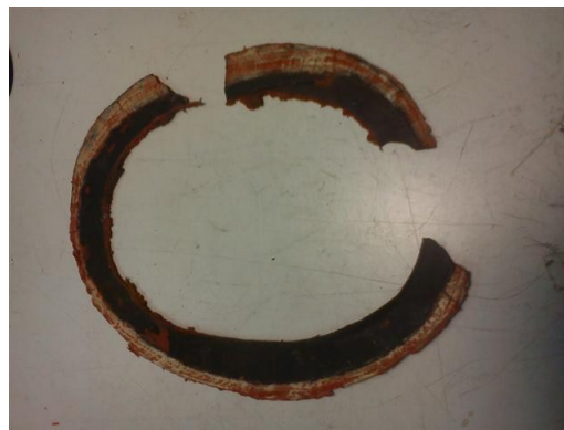
Figura 11: Estado de la junta removida
