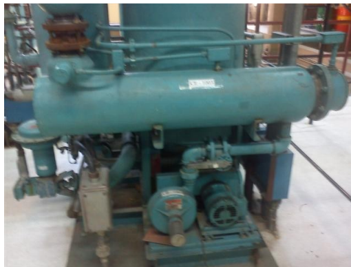
Figura 5: Sistema de inyección de aire caliente (CE 1003) para secado de alúmina
