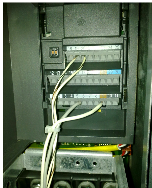
FIGURA N° 8: Vista del cableado de control del variador.
