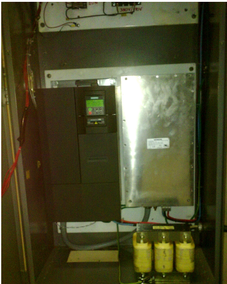
FIGURA N° 6: Vista del tablero de comando de rotating-shaft con el nuevo sistema con el variador electrónico y los filtros de entrada y salida.
