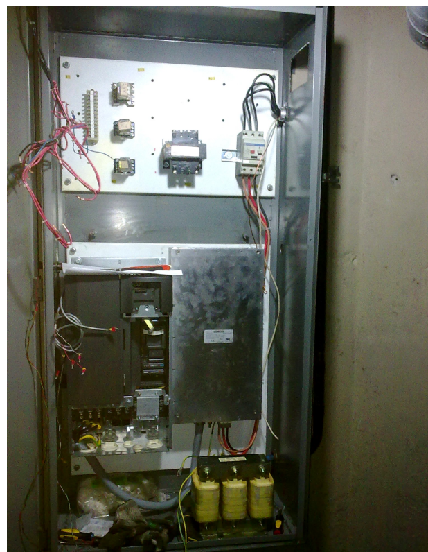
FIGURA N° 5: Vista del tablero de comando de rotating shaft con el nuevo sistema con el variador electrónico y los filtros de entrada y salida.
