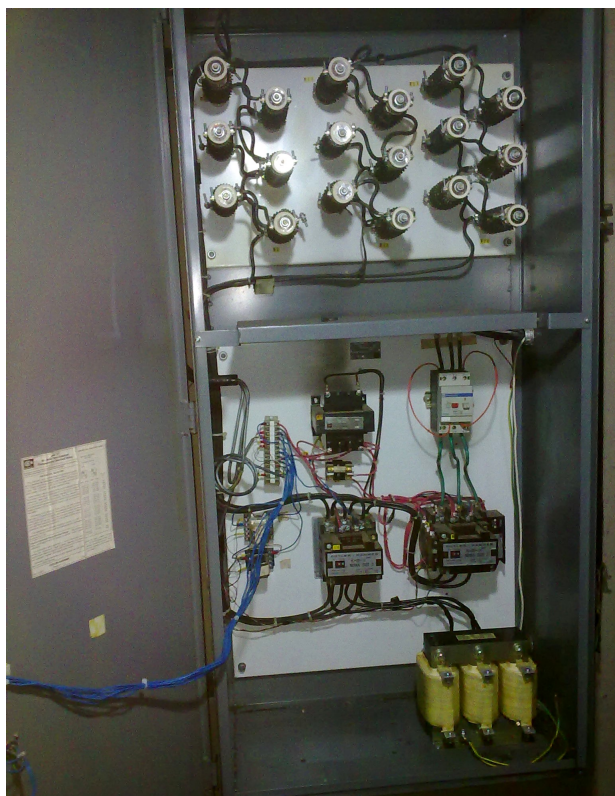
FIGURA N° 4: Vista del tablero de comando de rotating shaft con el viejo sistema con resistores y contactores.
