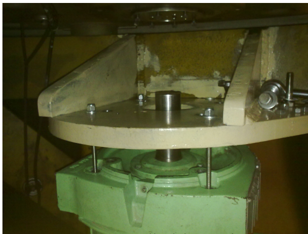
FIGURA N° 12: Detalle del montaje de motor del RS CB1
