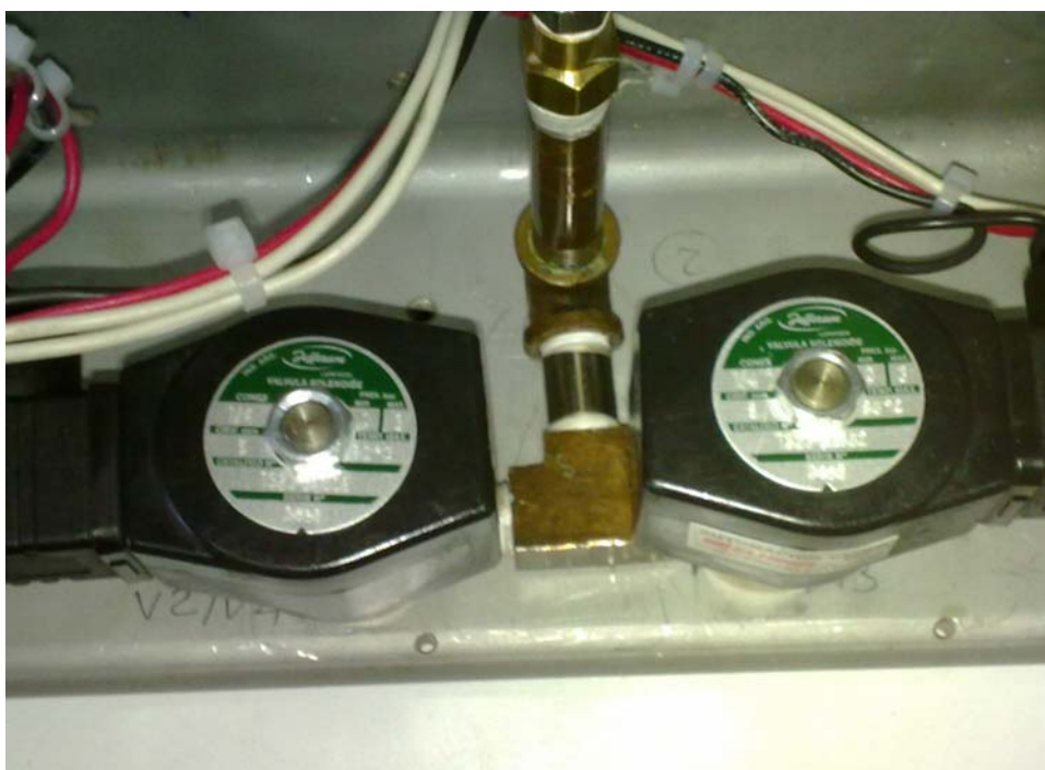
Fig. 7. vista de las válvulas solenoides dentro del gabinete
